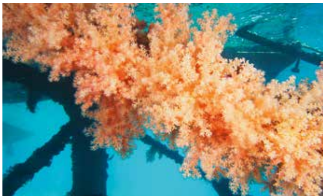
Die äusseren Träger des Jetty sind komplett mit Weichkorallen überwachsen.
